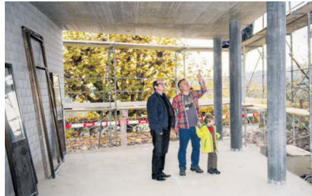
Architekt Volker Mohr und Vereinspräsident Beat Schmocker mit Sohn Nick im Rohbau des Mehrzwecksaals des Wohnheims Schönhalde, der auch als Cafeteria genutzt werden soll. Bild: Daniel Thüler
